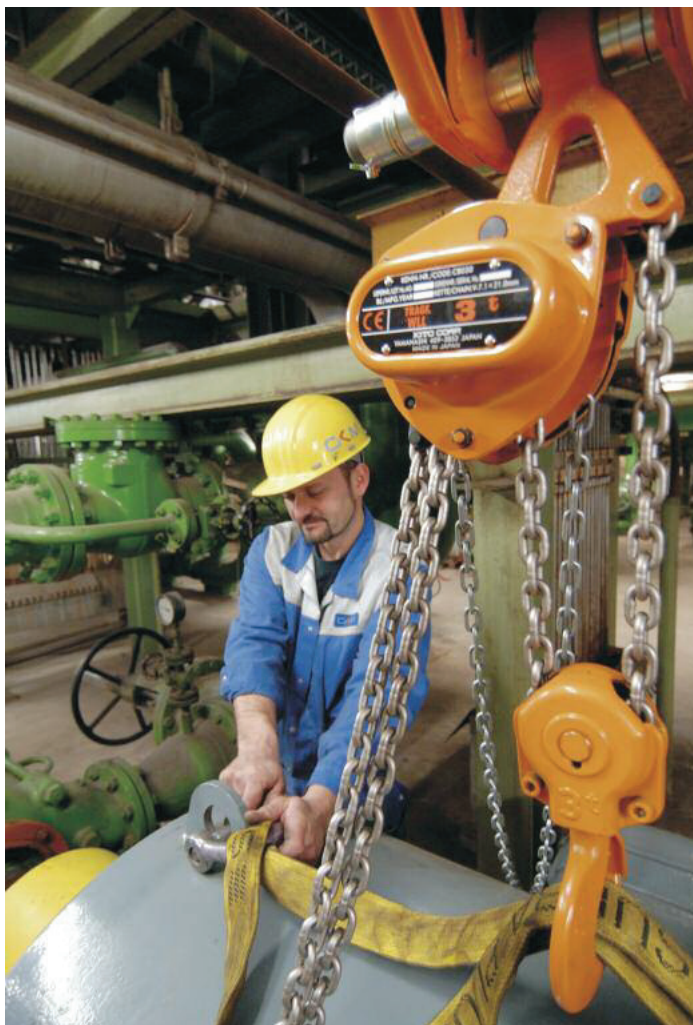
Das Großkraftwerk Mannheim setzt 18 Handkettenzüge der Serie CB von Kito Europe für Wartungsaufgaben ein
